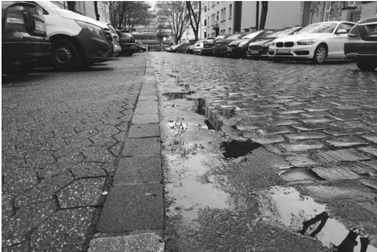
Die Barbarastraße hat eine Sanierung dringend nötig.
